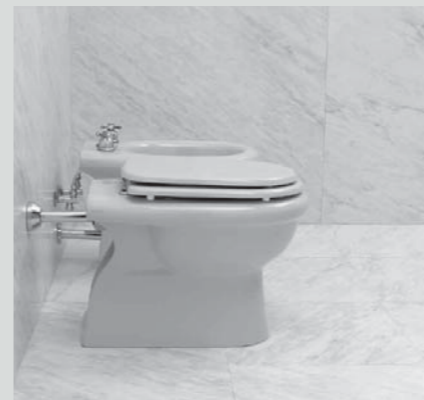
Vecchio impianto. Old installation.
