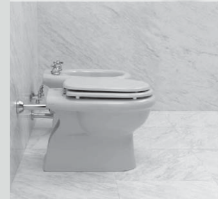
Vecchio impianto. Old installation.
