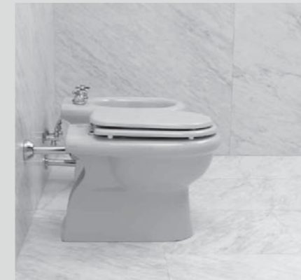
Vecchio impianto. Old installation.
