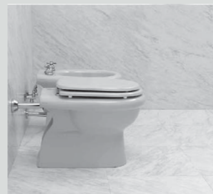
Vecchio impianto. Old installation.
