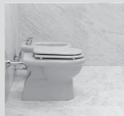
Vecchio impianto. Old installation.
